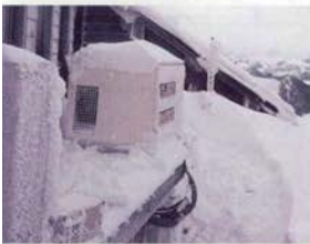
▲ Extreme Bedingungen im ersten Winter für die STIEBEL-ELTRON-Wärmepumpe
