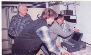
▲ Ein fest installierter Rechner und ein eigens von Josef (Sepp) Reisinger geschriebenes Programm steuert und überprüft permanent die Wärmepumpen-Anlage. Hier beim Datenabgleich: (v.l.): Gerd Badstübner, Josef Reisinger und Johann Naßl
