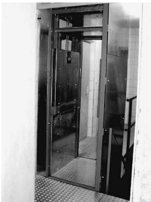
Lastenaufzug in den Keller
